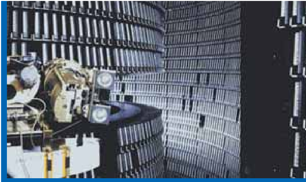
Vue d'un système de stockage robotisé de bandes magnétiques du DKRZ.
